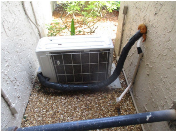
17 HVAC Mini Split
