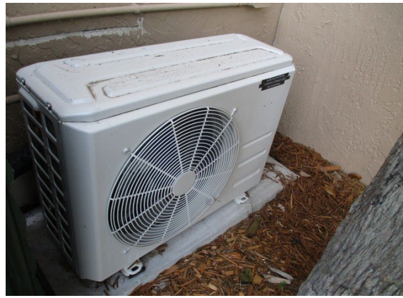
58 HVAC Mini Split
